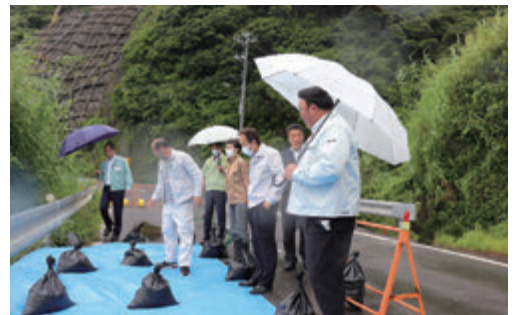
▲ 大雨による県道御坊由良線崩落現場
