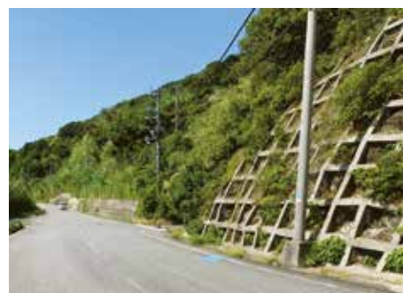
▲災害時に山のり面崩落が懸念される
