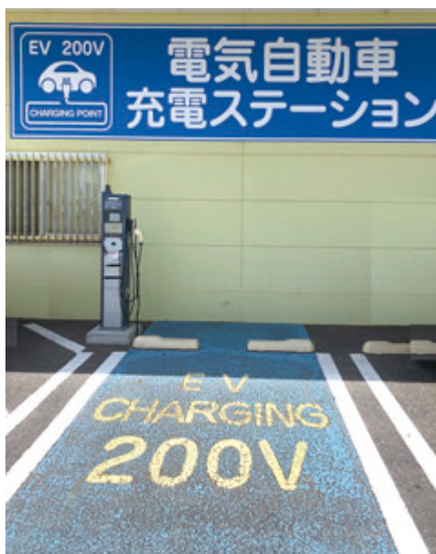
▲ EV車普通充電設備
