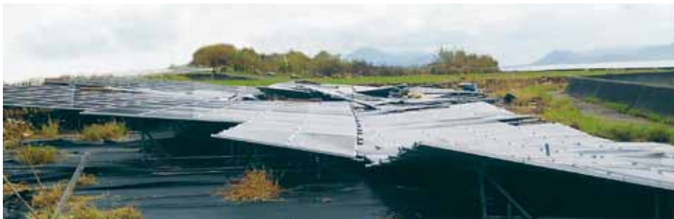
▲二次災害が懸念される被災太陽光パネル
