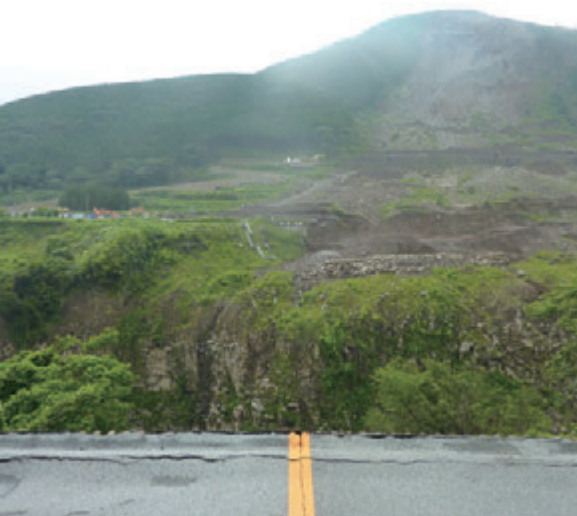
▲落橋した阿蘇大橋現場
